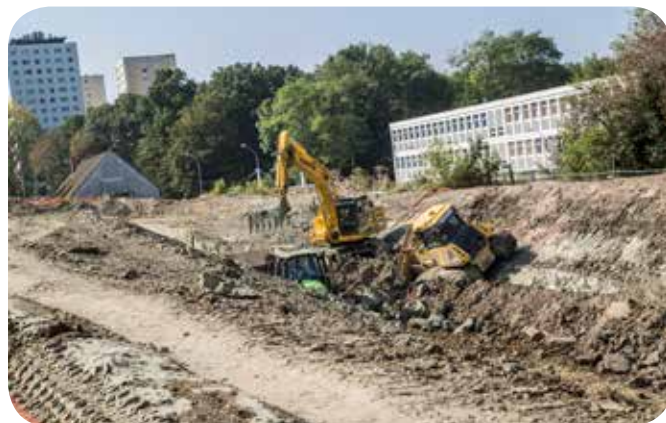
Travaux au niveau de la Voie Nouvelle (pelouse de la Mairie de Clichy-sous-Bois)
